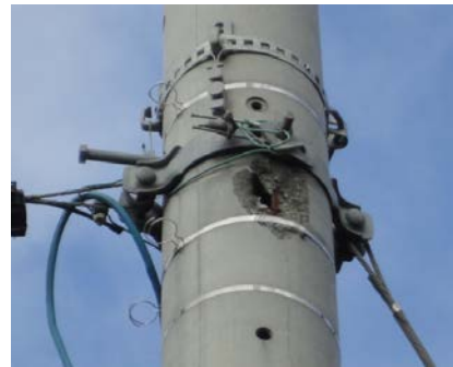
図 2 電柱のコンクリート剥離例
