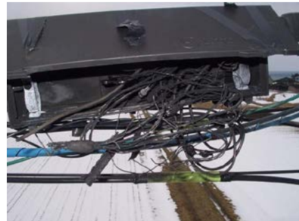
図 3 接続端子函の損傷例
